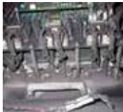
传统UPS内部积灰状态
